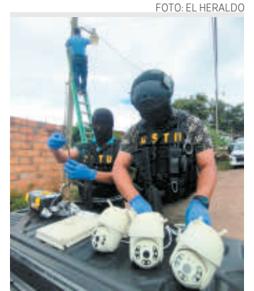
FOTO: EL HERALDO Las cámaras estaban en los postes del tendido eléctrico.
